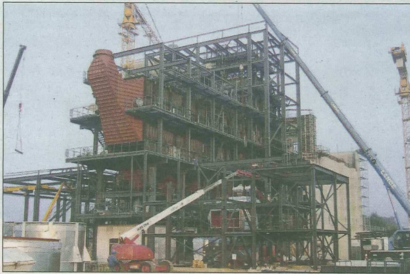
Na takie proekologiczne inwestycje czekamy na Śląsku: AVA Nordweststadt Frankfurt Spalarnia 550.000 Mg odpadów/rok. Parametry: wydajność 68,2 t/h; ciśnienie 80 bar, temp. 545°C
